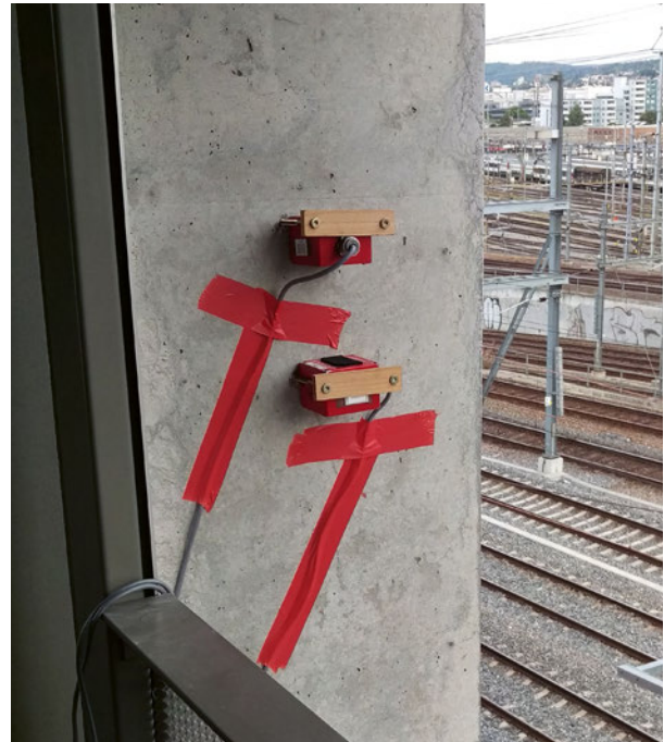
Die Spickbewegungen treten gleichzeitig mit den Knackgeräuschen auf. Die Messinstrumentierung nimmt beides auf: Horizontale Schwinggeschwindigkeitssensoren erfassen die Bewegung der Tragstruktur direkt an der Fassade , während ein Mikrofon im Innenraum (nicht im Bild) den hörenden Menschen simuliert und den abgestrahlten Körperschall bzw. das Knacken aufnimmt.
